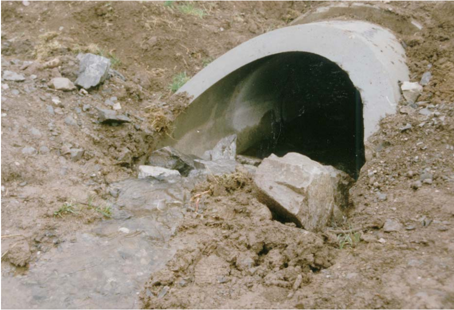
Verlegung eines Grabens. Das Verbindungsrohr zwischen alten und verlegten Grabenabschnitt ist während der Bauphase als Tierdurchlass kaum geeignet.
